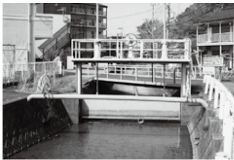
田松川上流水門
