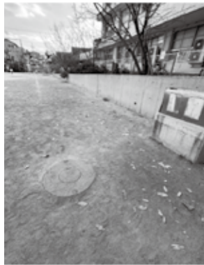
10基のマンホールトイレと、トイレ用ポンプ
