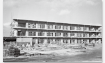
昭和33(1958)年 建設工事の様子 この校舎は、解体されるまで約65年間使われました。
