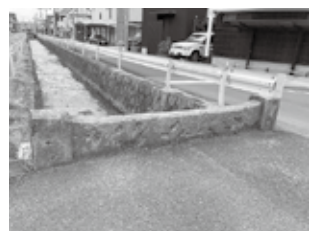
爆弾跡が残る橋 (鳴尾北小学校東門前)
