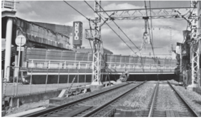
落ちた門戸跨線橋が線路をふさぐ 『阪神・淡路大震災20年誌』より
