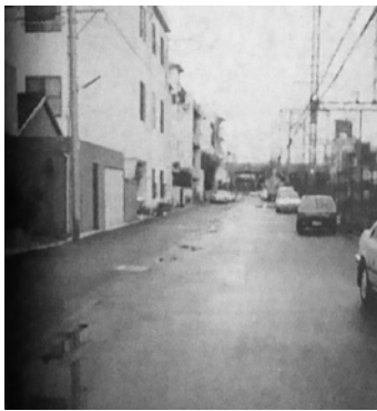
阪神本線久寿川駅より西、下水溝の移設。線路北側に仮線を敷設
